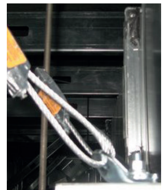
Arriostamiento de conductos rectangulares de ventilación
